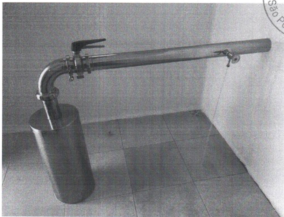
Figura 2: Cabeça do poço em aço inoxidável. Observar torneira de amostragem conforme especificações técnicas.
